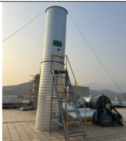
排气筒及采样平台
